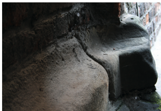
Ryc. 9. Kanał osuszający – fragment kamiennego cokołu elewacji zach. i narożnej przypory korpusu nawowego (2 poł. XIII w.), fot. H. Rojkowska
