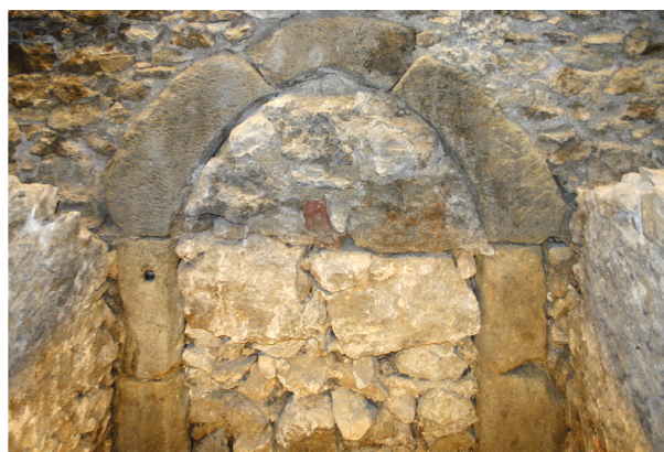
Ryc. 2. Zamurowany portal w części południowej (frontowa ściana przedproża południowego). Widok po konserwacji, fot. M. Sawicki
