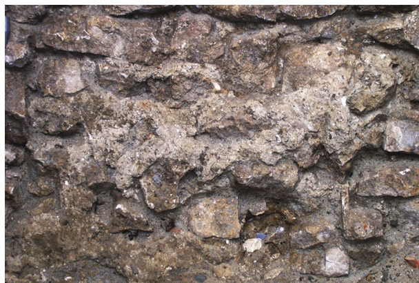
Ryc. 5. Fragmentarycznie zachowane pozostałości zapraw spoinujących i licujących. Stan w trakcie wykopalisk, fot. E. Holcer
