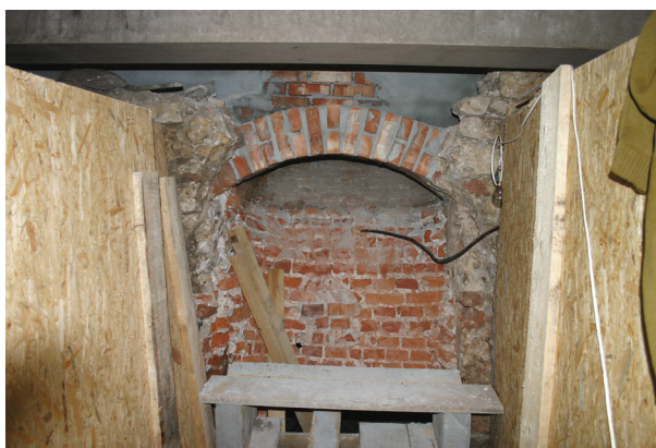
Ryc. 3. Fragment zamurowanego wejścia (częściowo zrekonstruowanego w partii łuku) w północnej części przedproża. Widoczne rozległe zniszczenia podstawy łuku ceglanoego. Widok w trakcie konserwacji, fot. M. Sawicki
