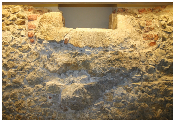
Ryc. 10. Relikty południowego okna przedproża północnego z częściowo zrekonstruowanymi partiami wątku ceglanego i kamiennego. Widok po konserwacji, fot. M. Sawicki
