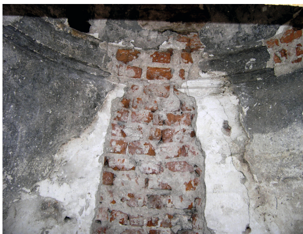
Ryc. 20. Fasada, drugie piętro, wnęka między drugim i trzecim oknem od północy. Górna część konchy poniżej gzymsu. Na tle ciemnego tynku jasne plamy, obwiedzione wyraźnym konturem. W osi wnęki nieotynkowany pas ceglanego muru, fot. Ł. Holcer
