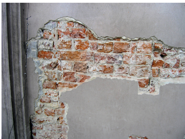
Ryc. 13. Fasada, pierwsze piętro. Pionowy pas skutych cegieł między trzecim i czwartym oknem od południa. Pośrodku wyraźna cezura; druga, mniej regularna po lewej, przy kamieniarce okiennej, fot. Ł. Holcer
