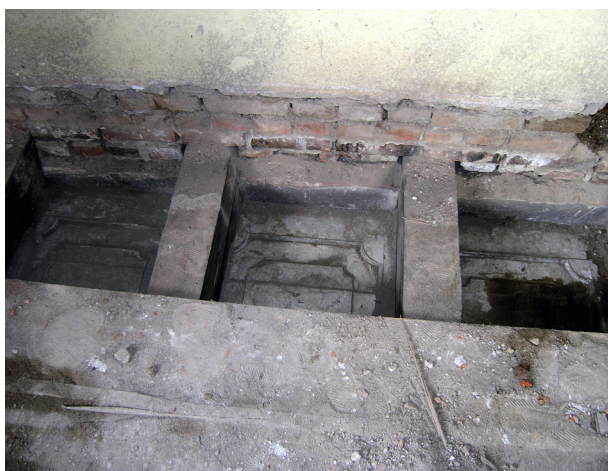
Ryc. 40. Trzecie piętro, pomieszczenie nr 417. Osadzenie fazowanych belek w ścianie północnej. Między belkami otynkowane czółka ceglane. Niżej, profilowane płyciny przybite bezpośrednio do belek, fot. Ł. Holcer
