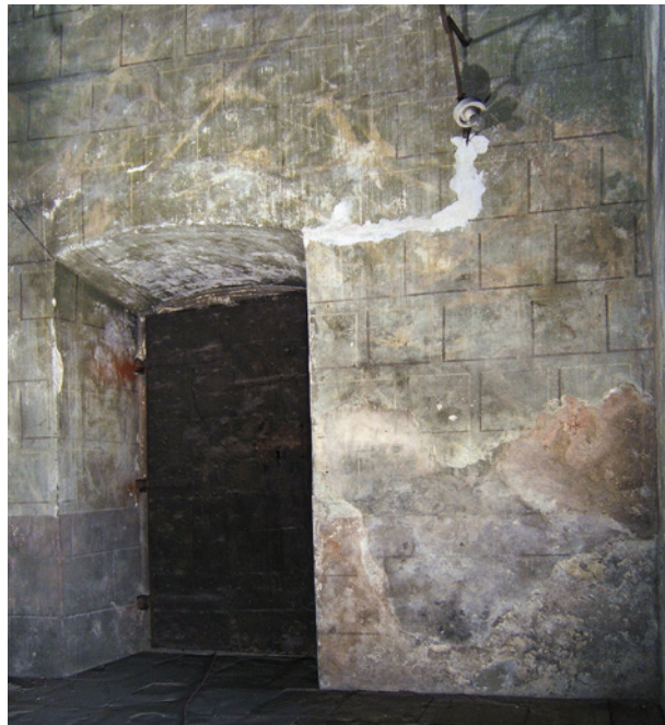
Ryc. 13. Wejście do zakrystii w ścianie północnej pomieszczenia przed rozpoczęciem badań; fot. I. Jakubczyk
