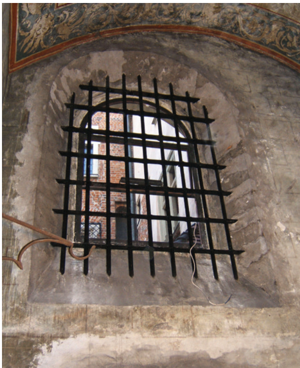
Ryc. 12. Renesansowe okno ze współcześnie wprowadzoną kratą we wschodniej ścianie zakrystii. Stan przed konserwacją; fot. I. Jakubczyk
