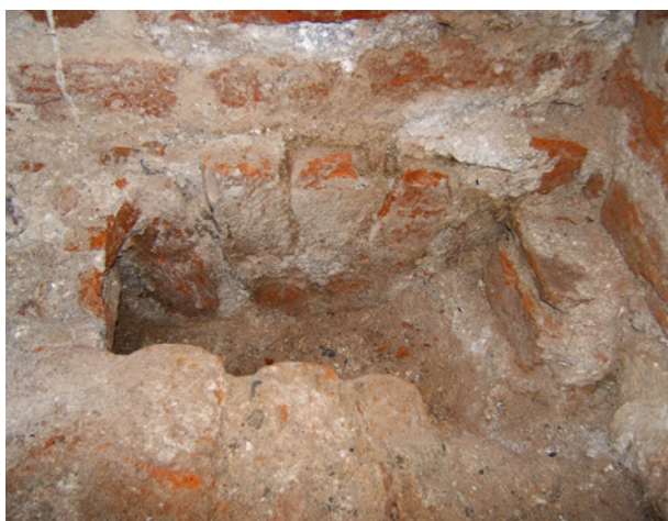
Ryc. 51. Łęk ceglany odkryty w wykopie narożnym w ścianie północnej zakrystii; fot. I. Jakubczyk
