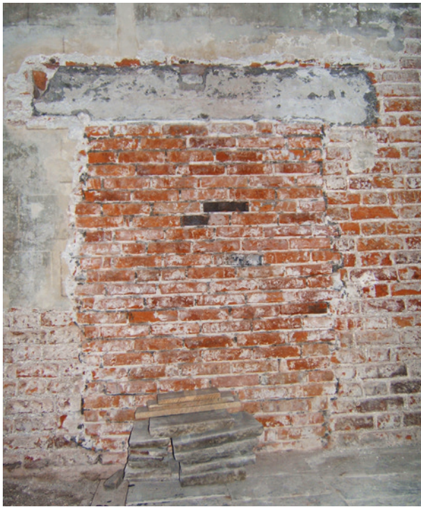
Ryc. 18. Współczesne zamurowanie wtórnego otworu wejściowego (wnęki?) w ścianie wschodniej z udziałem cegły maszynowej łączonej zaprawą cementową. Ponad nim wzmocnienie w postaci belki betonowej; fot. I. Jakubczyk
