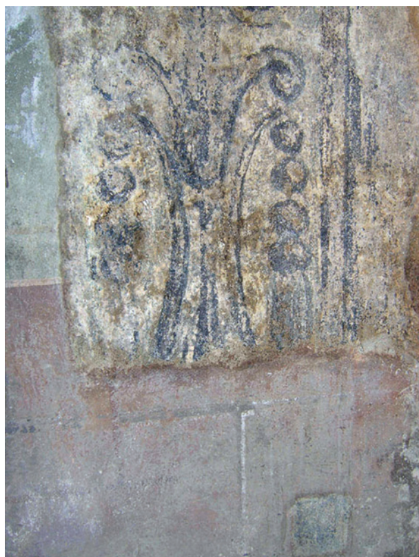
Ryc. 35. Fragment wschodniej płaszczyzny wnęki wejściowej w trakcie odsłaniania renesansowej dekoracji malarskiej; fot. I. Jakubczyk
