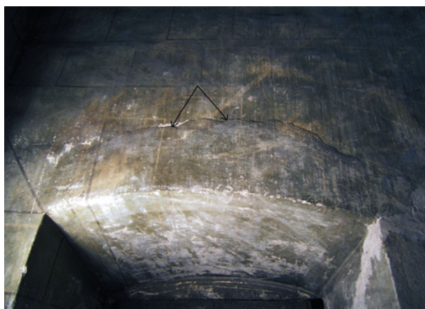
Ryc. 29. Granica tynku położonego w rejonie wejścia do zakrystii, zatartego na krawędzie starszej wyprawy ściany północnej; fot. I. Jakubczyk
