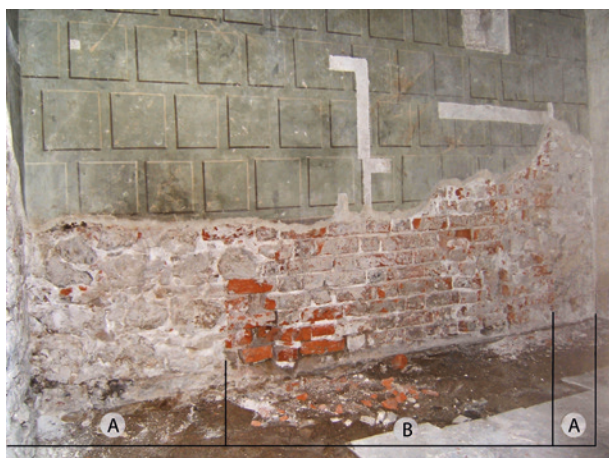
Ryc. 20. Dolna część ściany zachodniej po usunięciu wtórnych tynków. Widoczny ceglany wążek wschodniej absydy gotyckiej kaplicy Grota z ok. 1344 r. (B) i kamienne wyrównanie ściany zakrystii przy jej zewnętrznych krawędziach (A); fot. I. Jakubczyk
