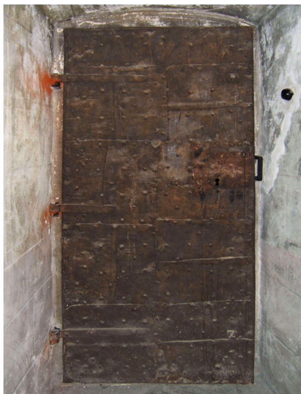
Ryc. 10. Drzwi żelazne (XVI w.) obecne w otworze wejściowym w ścianie północnej zakrystii. Złożone z prostokątnych metalowych płyt różnej wielkości, łączonych i wzmacnianych od strony kaplicy pasami żelaza, mocowanymi przy pomocy ćwieków. Stan przed konserwacją; fot. I. Jakubczyk
