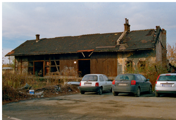
Zrujnowany (rozebrany w 2005 r.) zabytkowy budynek ekspedycji towarowej na stacji Kraków Wisła, fot. Elżbieta Firlet, 7 kwietnia 2002 r.; w zbiorach MK, nr inw. DAU PG 1909
