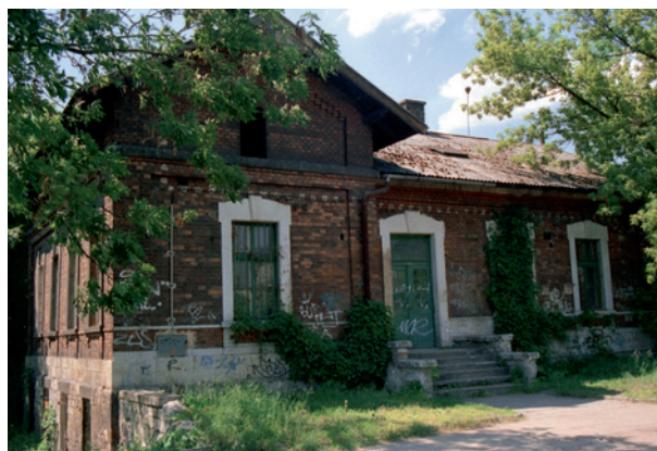
Rozebrany w 2003 r. zabytkowy budynek biura telegraficznego Kolei Północnej Cesarza Ferdynanda przy ul. Warszawskiej 35, fot. Elżbieta Firlet, 18 maja 2000 r.; w zbiorach MK, nr inw. DAU SM 3067
