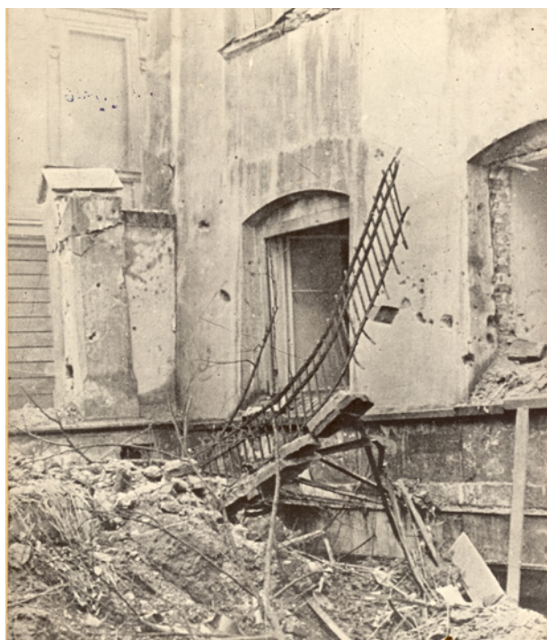
Zniszczenia budynku Collegium Minus przy ul. Gołębiej 11. Widok od strony ogrodów profesorskich, na pierwszym planie rumowisko gruzu, kamieni, gałęzi, zerwanych barierok. Po prawej stronie widoczny fragment północnej fasady budynku i fragment muranego ogrodzenia ogrodów. W głębi fragment fasady budynku stojącego przy ul. Jagiellońskiej, 18 stycznia 1945 r.; w zbiorach MK, nr inw. MHK-Fs20617/IX
