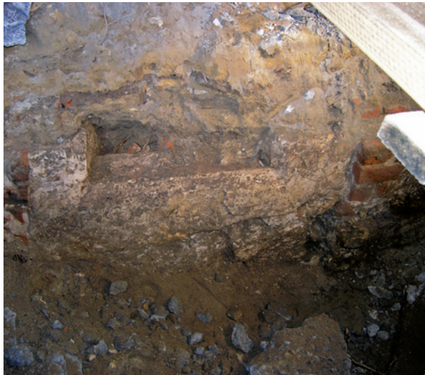
Ryc. 27. Przedproże północne, ściana wschodnia, drugie okno od strony północnej. Dolna, zachowana część kamiennego obramienia okna. W węgarach i parapecie szeroka faza. Płaszczyzna kamieniarki oraz zamurówka pod parapetem, wyraźnie cofnięte w stosunku do lica ściany, fot. L. Holcer
