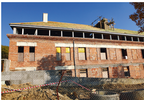
Stan prac podczas podnoszenia dachu w celu zwiększenia powierzchni dla pracowni konserwacji, 2012, fot. Andrzej Janikowski
